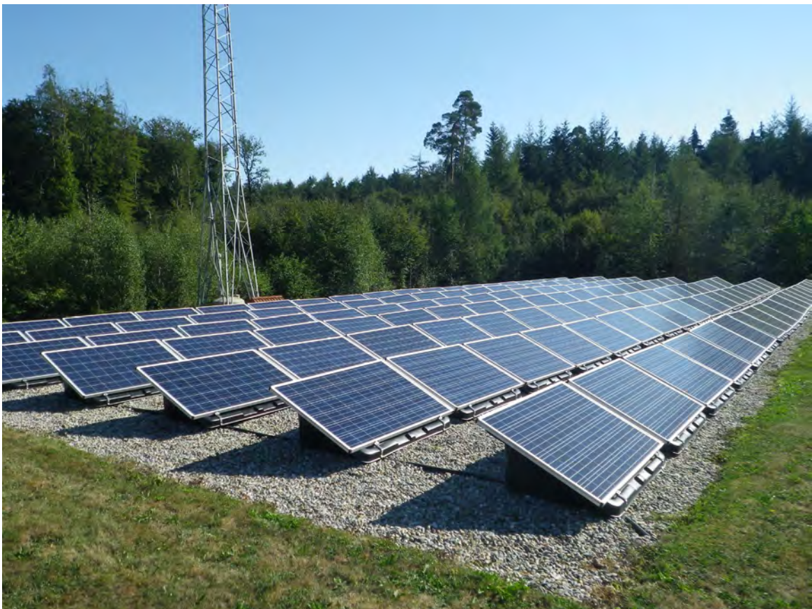
Photovoltaikanlage auf dem Hochbehälter Birket
